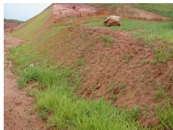
Figura 23 - Má fixação da massa de sementes no talude.
